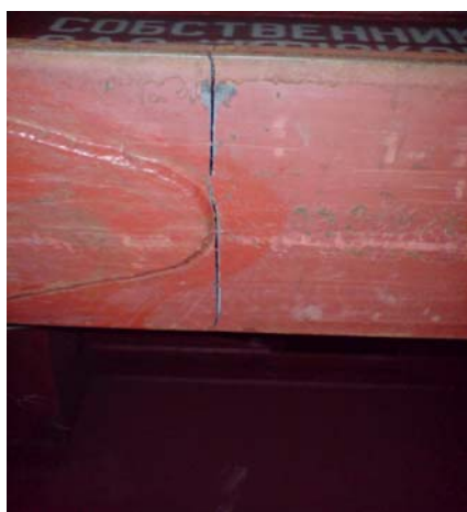
Рис. 7. Фото руйнування конструкції платформи, при випробуваннях на опір втомі, в зоні шва накладки в центрі бічній балки
